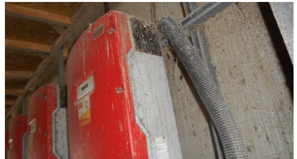
Omvormers in kippenstal. Foto: SOBH.
