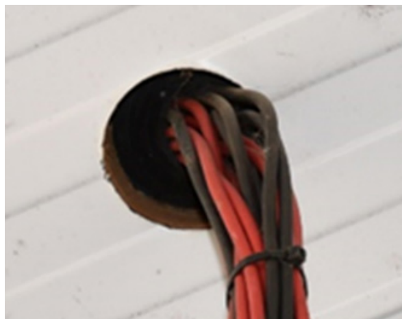
Voorbeeld van niet-afgedichte doorvoering van de bekabeling langs een scherpe rand. Foto: Brandweer Nederland.
